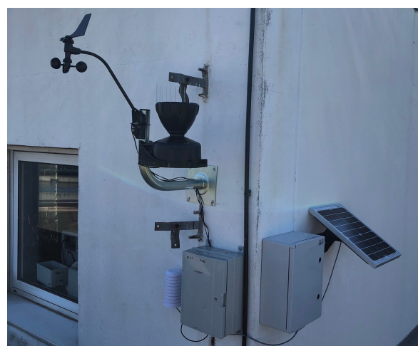
Station météo fixée sur le mur
